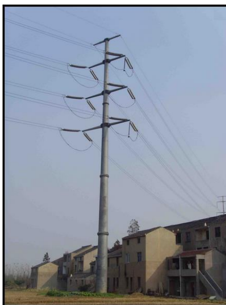
Figura 2.6: Poste de Metálico
