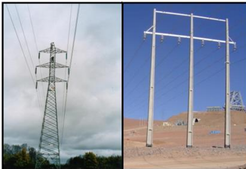
Figura 2.8: Estructuras tipo suspensión
