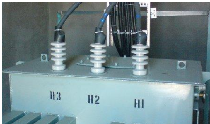
CAPITULO 2 10 BOQUILLAS ALTA TENSION DE UNA TRASFOMADOR
