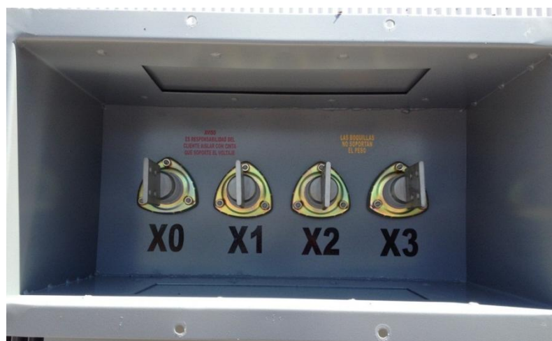
CAPITULO 2 11 BOQUILLAS DE BAJA TENSION DE UNA TRASFORMADO
