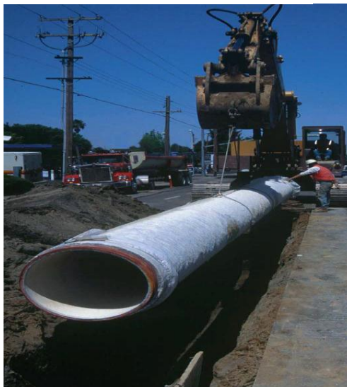
ILUSTRACIÓN 31 TUBERIA DE LA EMPRESA AMERICA PIPE
