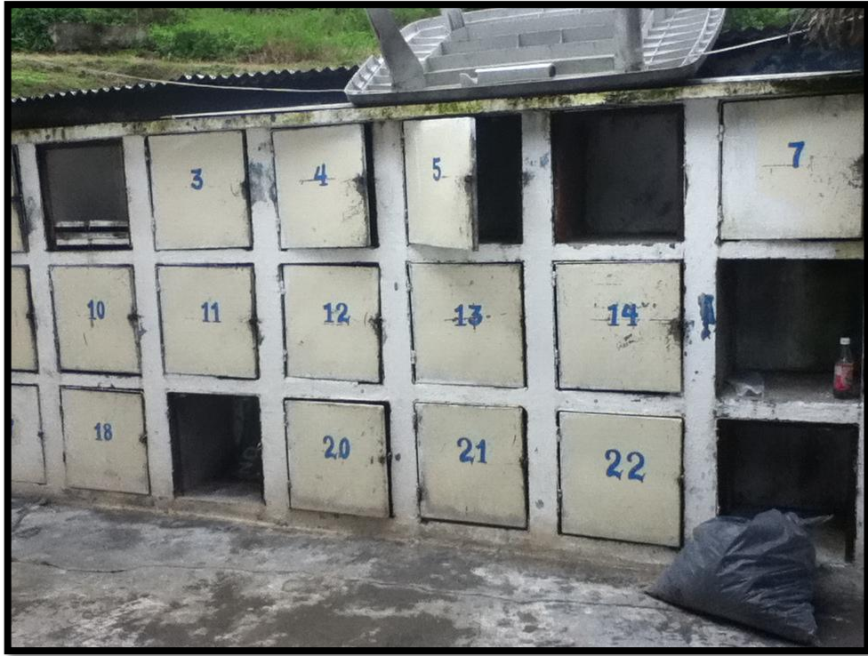
Figura# 37: Casilleros en mal estado del balneario Elaboración: Autor del Proyecto
