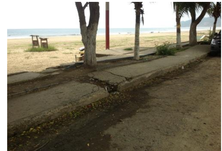
Imagen 1. Estado actual de aceras a lo largo del Malecón Julio Izurieta
