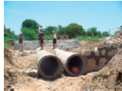
Imagen 33. Sistema de alcantarillado en Puerto López
