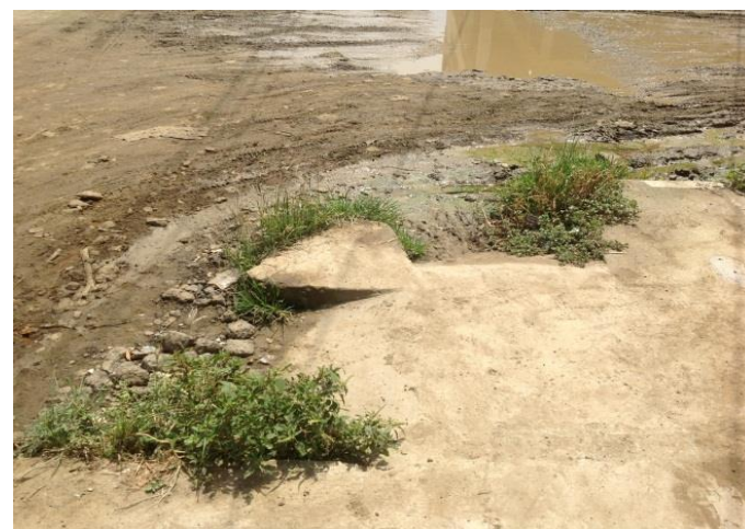
Imagen 1. Estado de rampas de acceso para discapacitados en Puerto López
