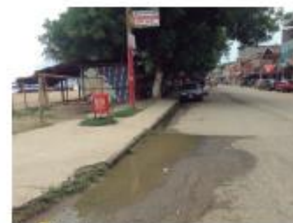
Imagen 39. Calles con lodo por lluvias
