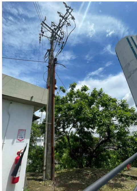
Figura 4-2 Acometida interna del campus UCSG.
