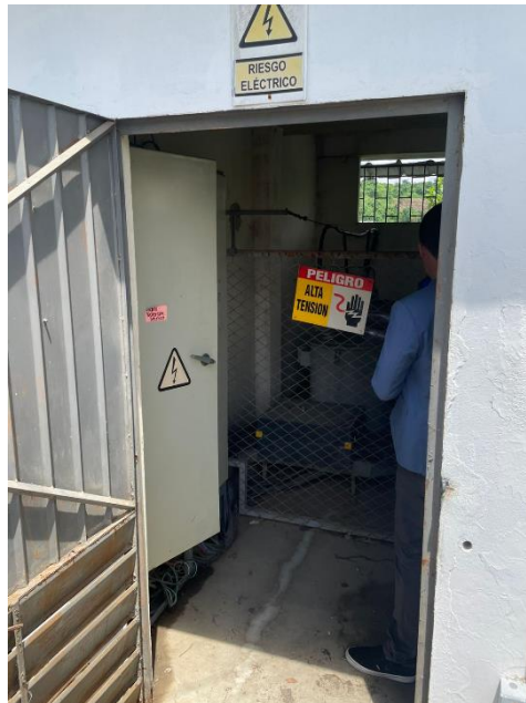
Figura 4-3 Entrada a cuarto de transformadores FETD.
