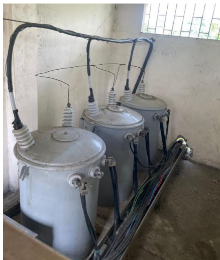
Figura 4-4 Banco de transformadores de la FETD.
