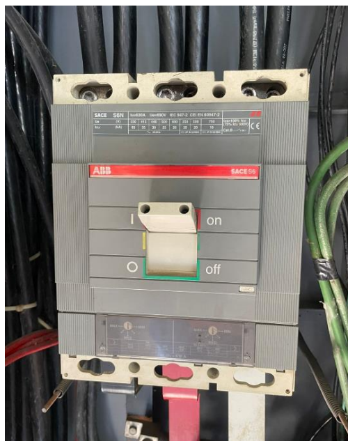
Figura 4-5 Interruptor automático principal.
