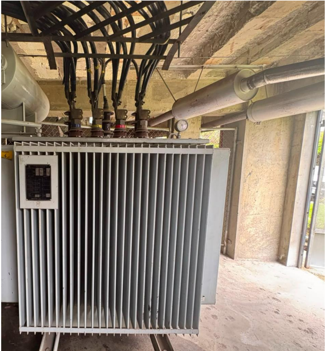
Anexo 4. Transformador de Distribución 750kVA
