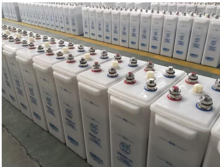
Figura 16. Baterías selladas de Ni-Cd
