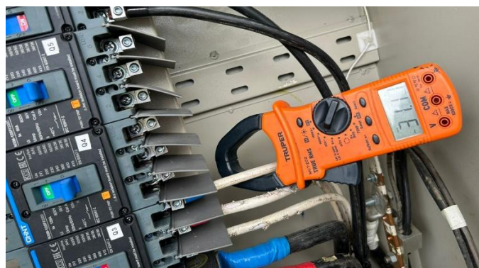
Figura 3.1: Medición eléctrica en tablero del Edificio Pastoral.
