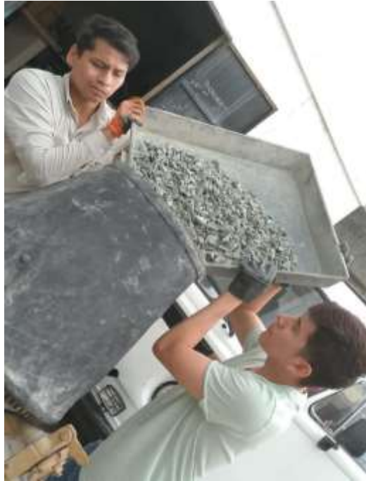
Ilustración 30. Proceso de vaciado de agregados pétreos previo al mezclado del hormigón. Fuente: Ilustración propia.
