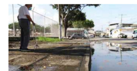
Agua emposada luego de lluvias
