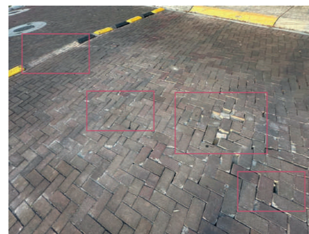
Anexo 3: Desgaste de adoquín en la calzada (Elaboración propia, 2025)
