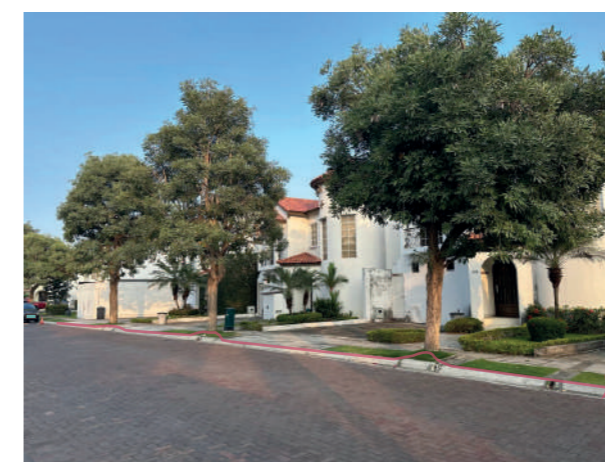
Anexo 17: Las raíces profundas deforman la acera (Elaboración propia, 2025)
