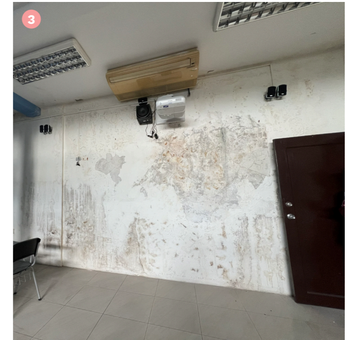
Figura 26. Pared con presencia de humedad. Fuente: Elaboración propia.
