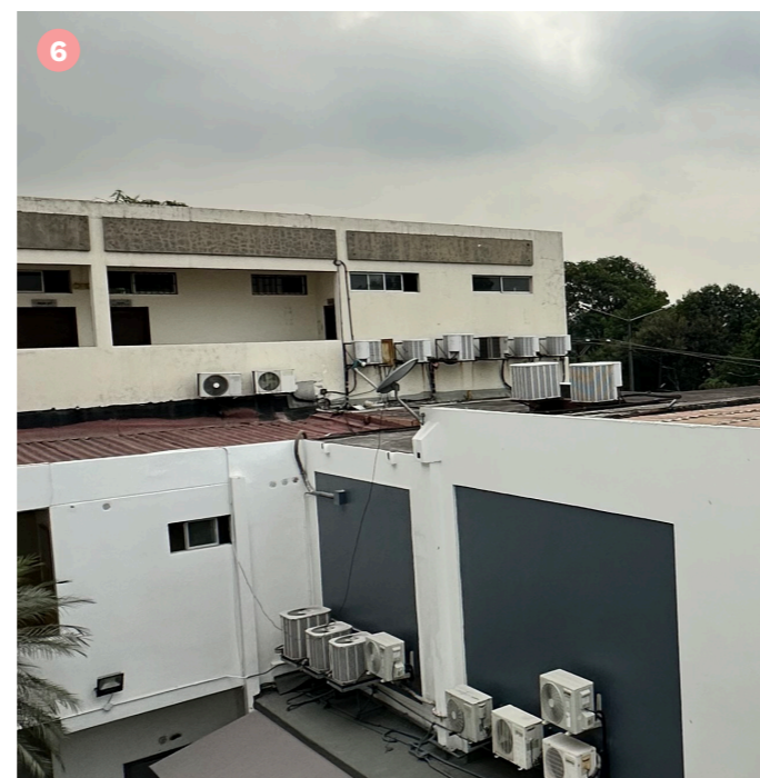
Figura 40. Pared con compresores de aire acondicionado. Fuente: Elaboración propia.
