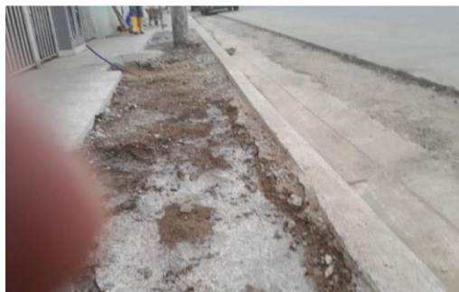
Figura 19. Ejemplo de acera parcialmente afectada
