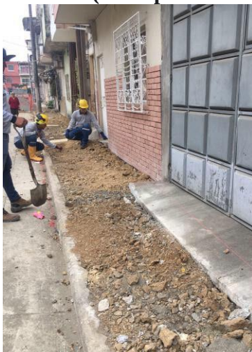
Figura 22. Ejemplo de aceras completamente afectadas
