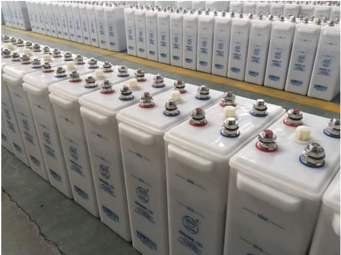
Figura 22. Baterías selladas de Ni- Cd
