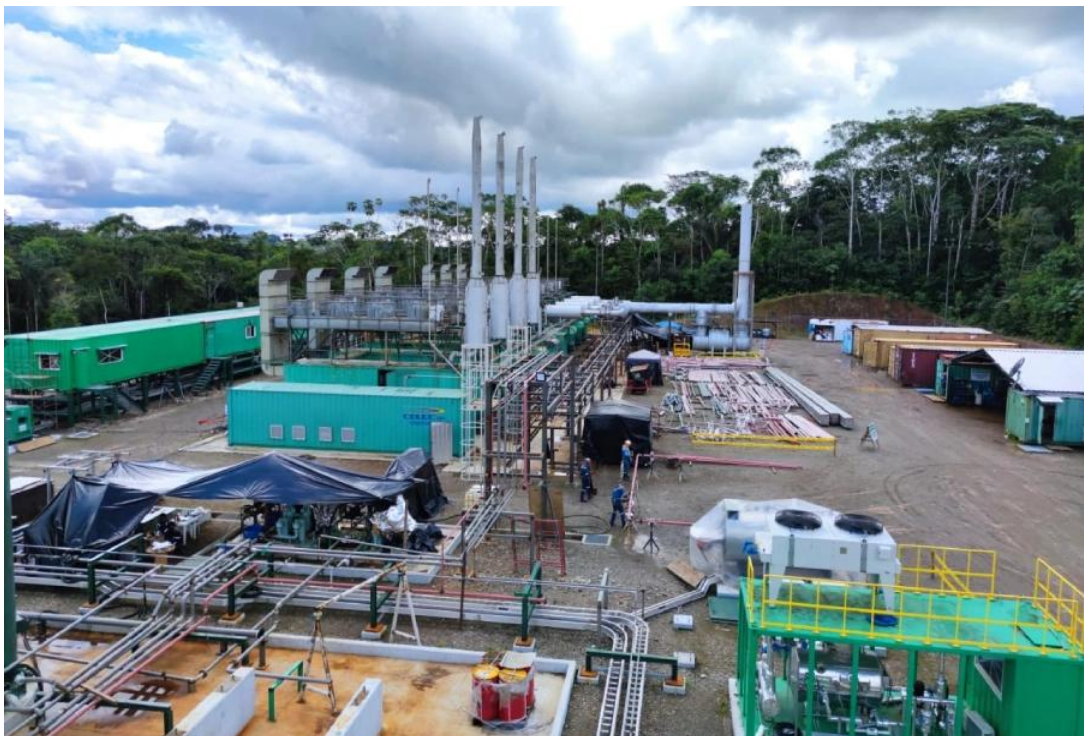
Figura 1. Central de generación térmica
