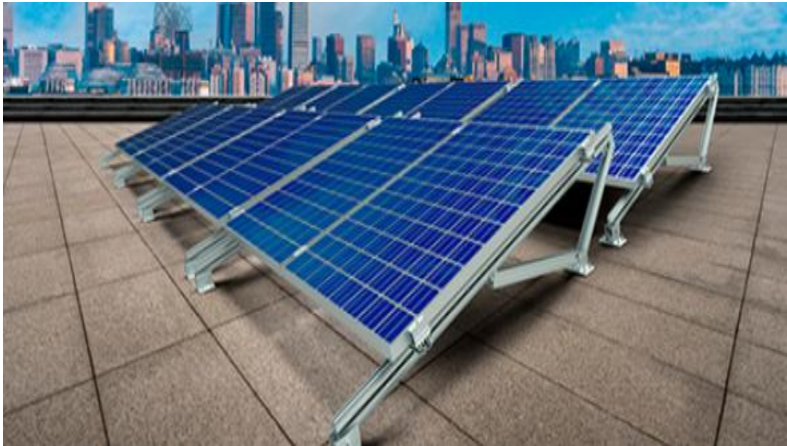
Figura 18. Estructura para inclinación de módulo fotovoltaico
