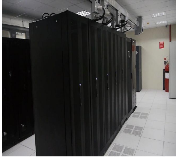
Figura 3. 1 : Data center principal de la cooperativa ubicado en la ciudad de Cuenca. Fuente: Autor
