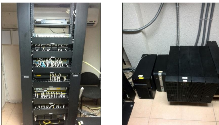
Figura 4. 3 Cuarto de telecomunicaciones de la agencia Guayaquil Fuente: Autor
