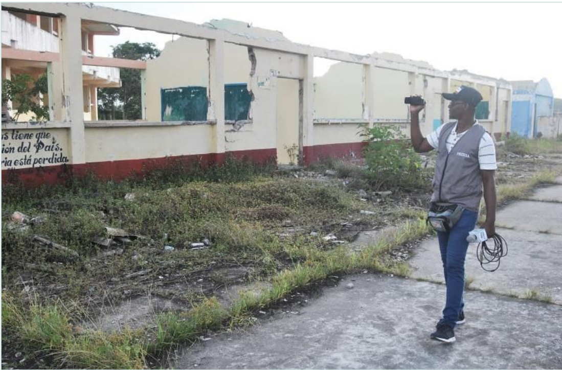
Ilustración 3 Unidad Educativa abandonada en Muisne; existe una carencia de infraestructura adecuada para la educación básica en la zona, lo que motiva el desarrollo de un nuevo centro educativo. Foto: Redacción / El Universo, Marzo 2023
