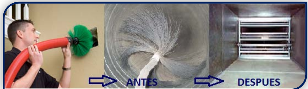
Ilustración 9: Shining Air Duct
