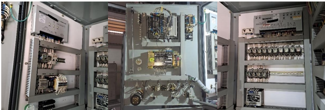
Figura 46 Vista de cableado original del panel de control
