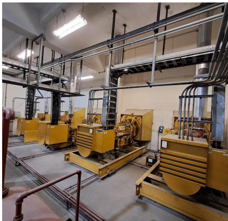
Figura 54 Vista panorámica de grupos electrógenos
