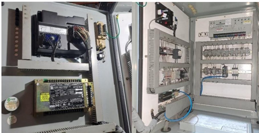
Figura 47 Integración nuevo panel de control
