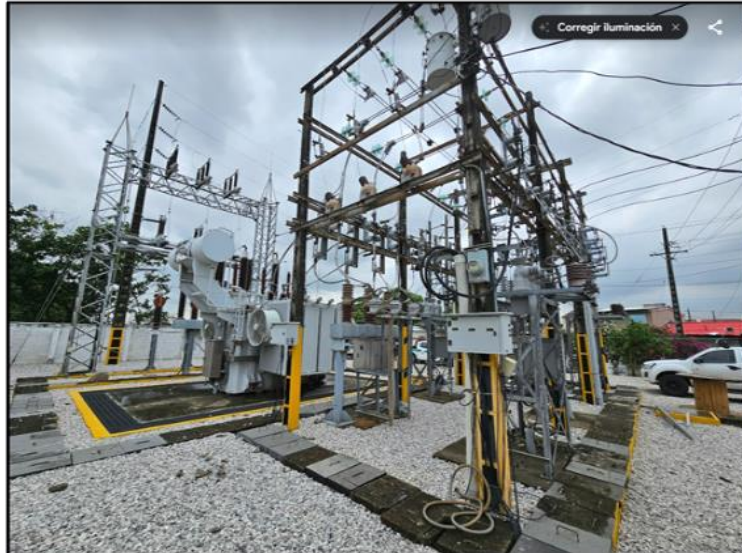
Figura 2. Subestación Villa Club Patio de 69 kV y 13.8kV
