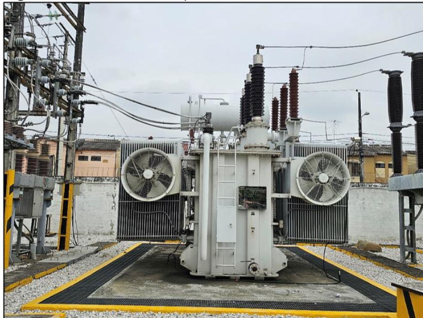
Figura 1. Transformador de potencia de la Subestación Villa Club
