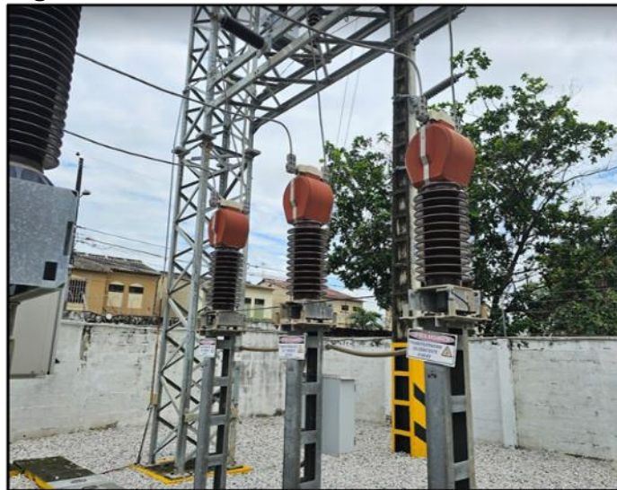
Figura 3. Transformadores de corriente.
