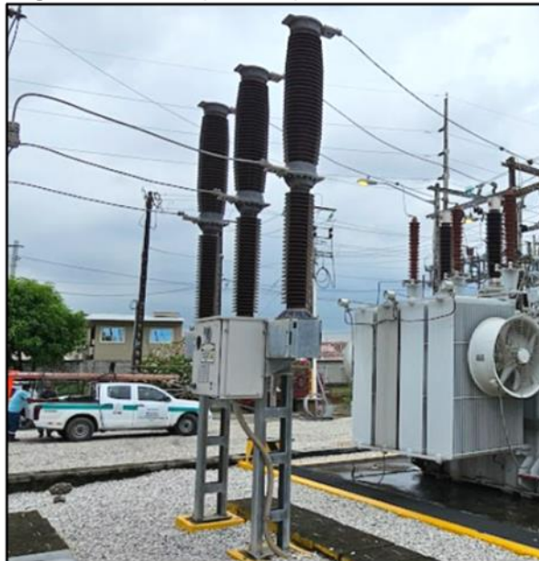
Figura 4. Interruptor de potencia 69 kV de la S/E.
