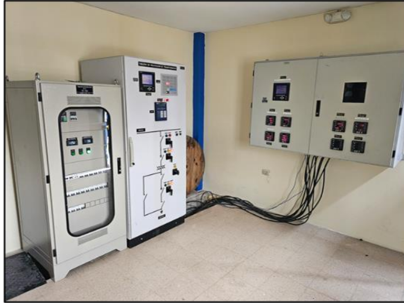
Figura 5. Sala de control de la Subestación Villa Club
