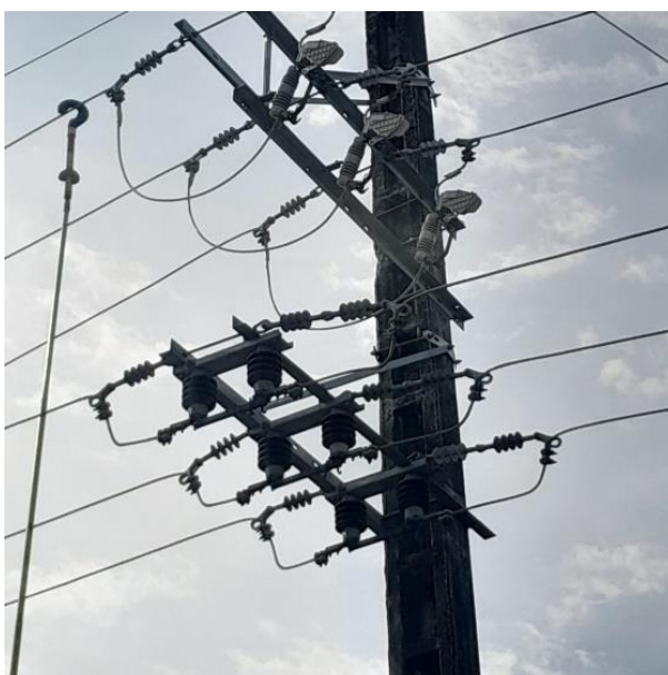
Figura A3: Medición en líneas en Primer Seccionamiento.
