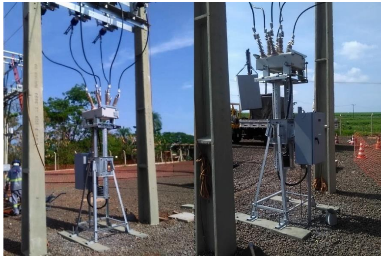
Figura 2.16: Reconectores instalados en subestaciones eléctricas.
