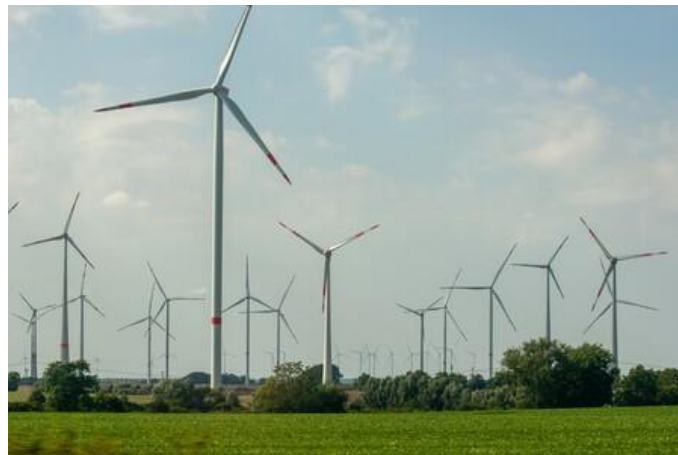
Figura 4: Conjunto de aerogeneradores conectados para la generación de energía eléctrica.
