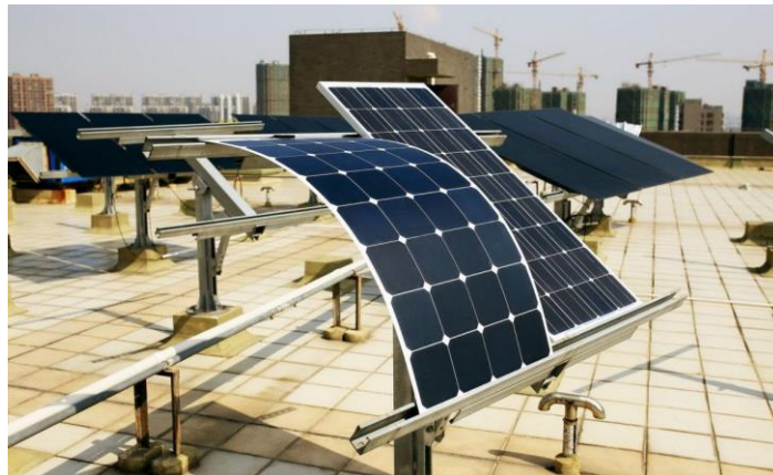
Figura 18: Paneles solares de capa fina.
