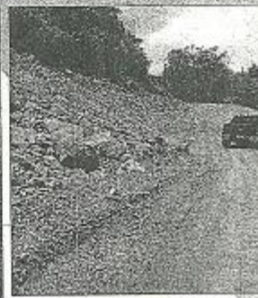
Kilómetro de camino que facilita el acceso de las maquinarias que ejecutan las labores.
