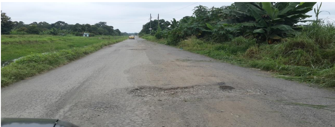
Imagen 3. Infraestructura vial en mal estado
