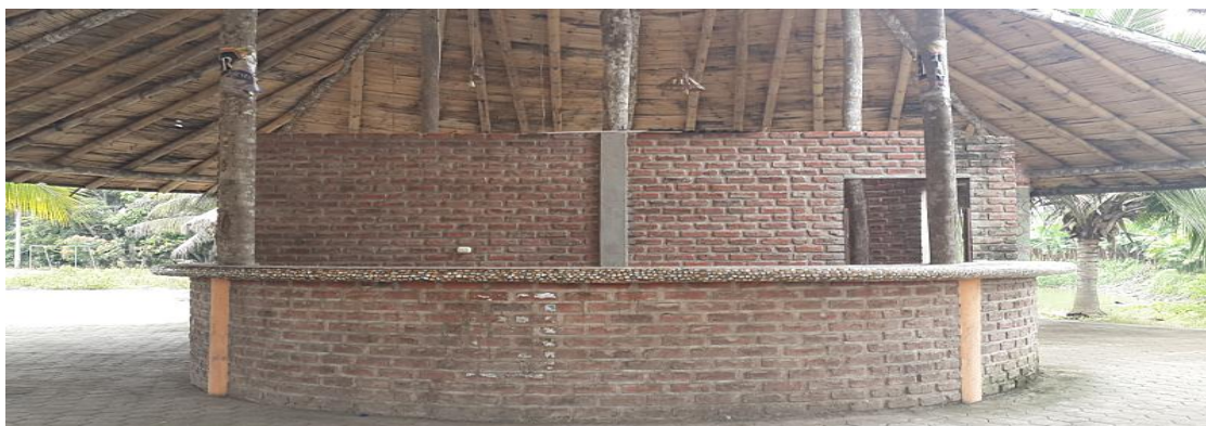
Imagen 5. Infraestructura turística deteriorada
