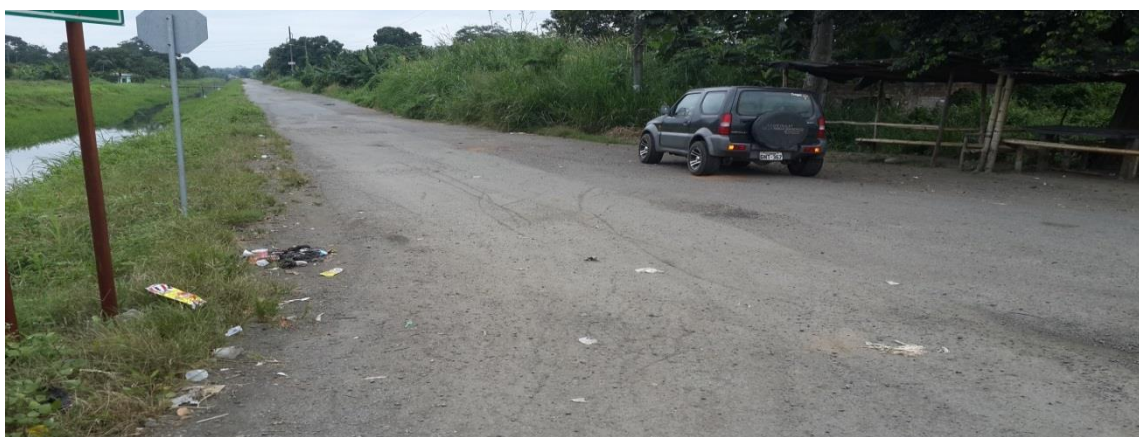
Imagen 1. Infraestructura vial en mal estado Fuente: Imágenes propias in situ
