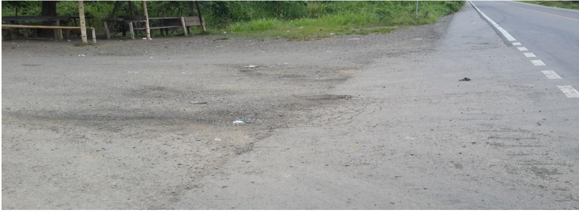
Imagen 2. Infraestructura vial en mal estado
