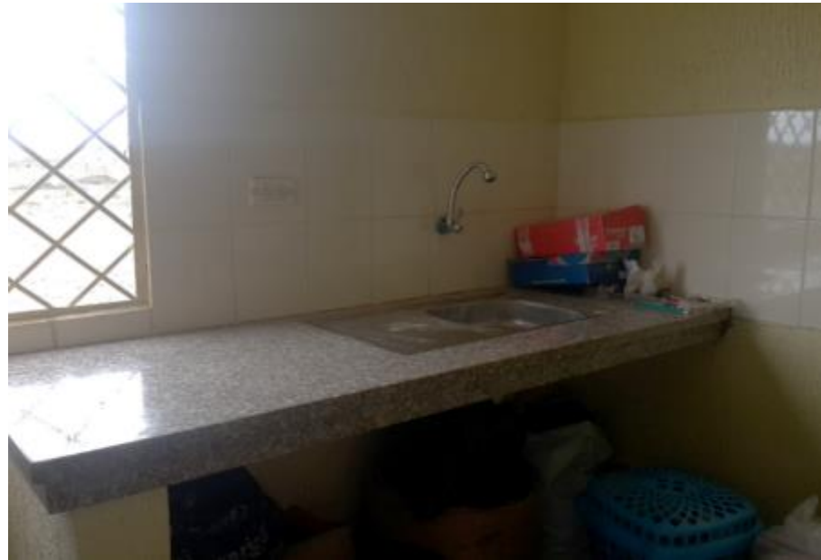
Figura 17.- Lavandería – CRADI (Manta) Fuente: Autora
