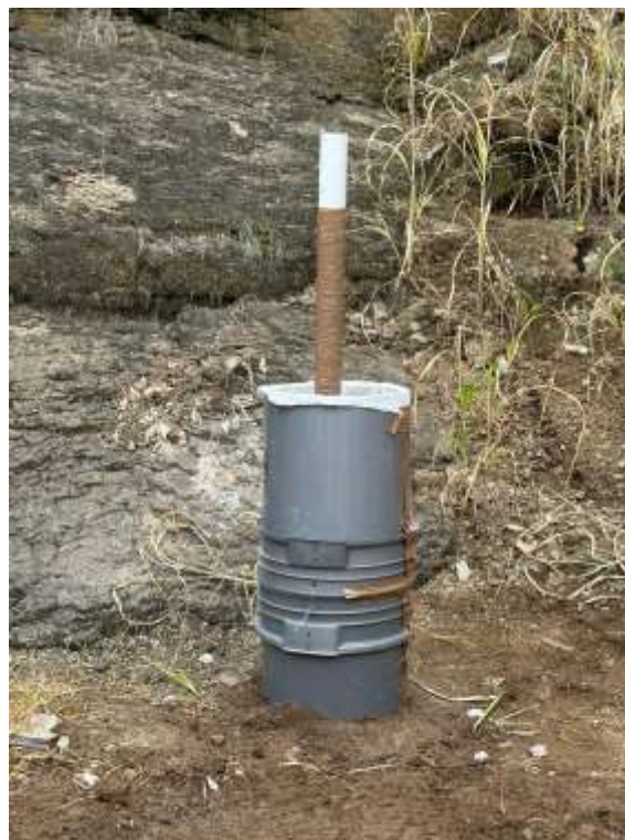
Figura 87. Colocación del geotextil tubular y el tubo de inyección dentro de la camisa de PVC.
