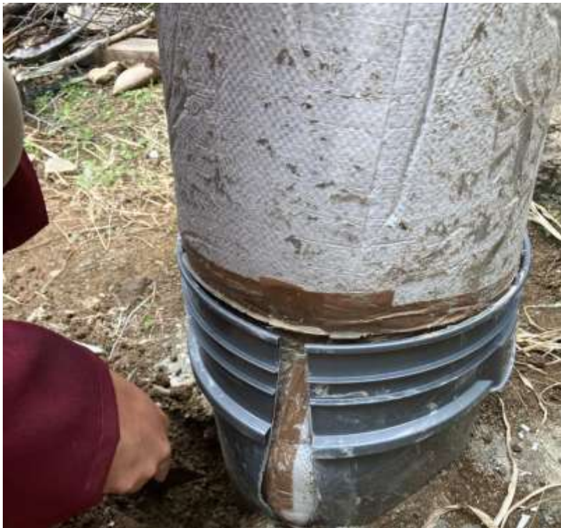
Figura 94. Abultamiento de la columna debido a falla de la camisa de PVC.
