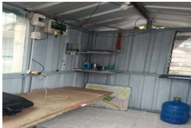
Figura 3. 4. Localización de regulador de voltaje 12V
