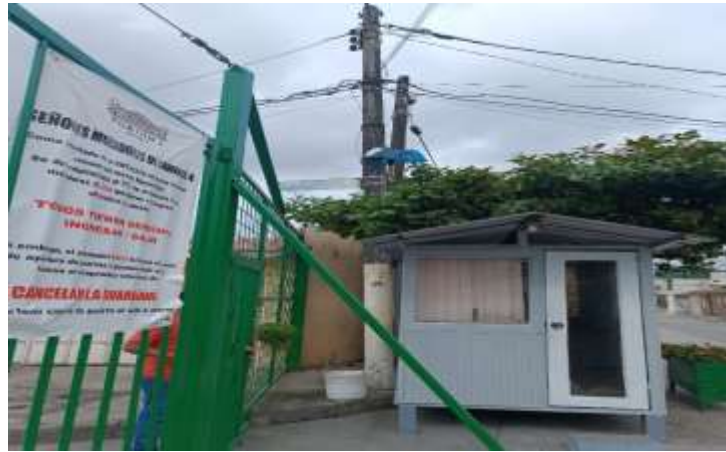
Figura 3. 3. Localización de fuente eléctrica 220V
