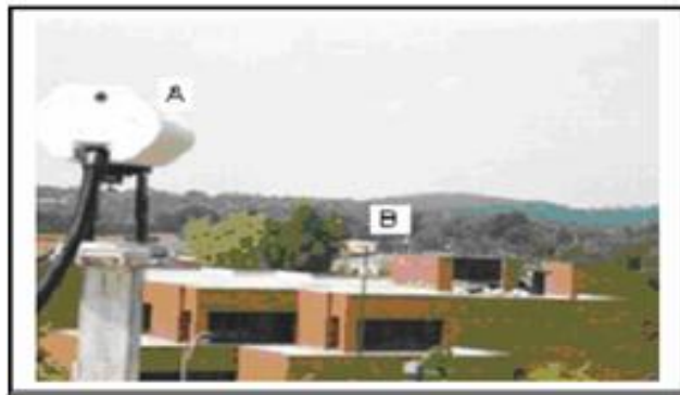
Figura 2. 10 Vista de un equipo FSO instalado en una azotea
