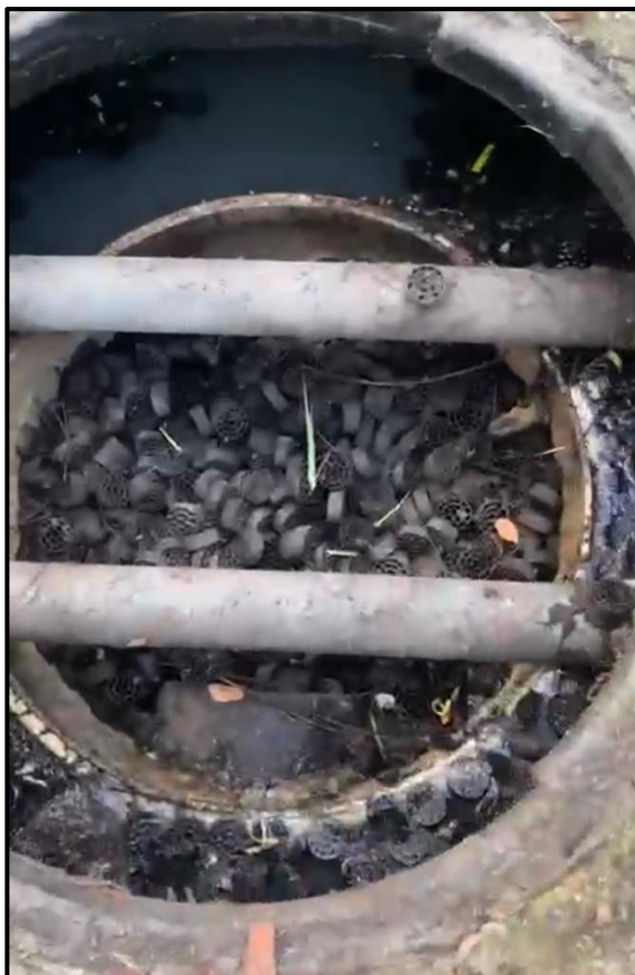
Figura 27 Rebosamiento del agua residual al filtro biológico ocasionando que se salgan los biofiltros.
