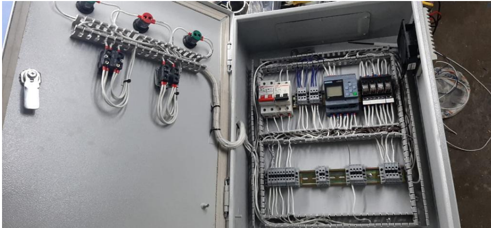
Figura 25 Dispositivos de un tablero de control
