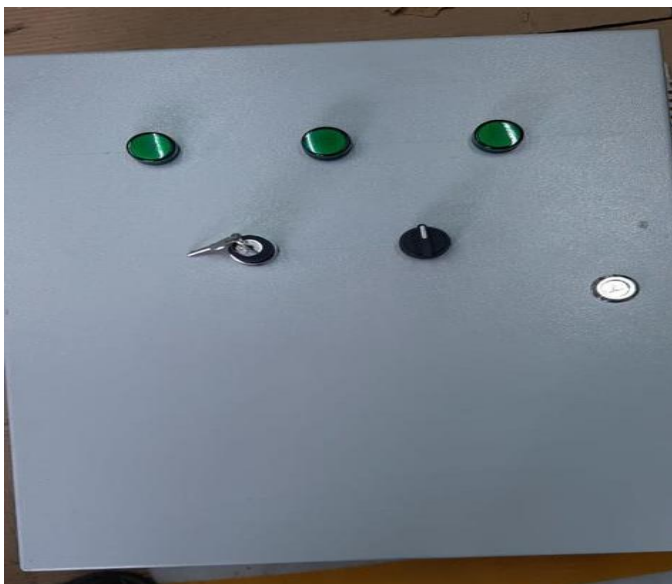
Figura 26 Parte frontal de tablero de control
