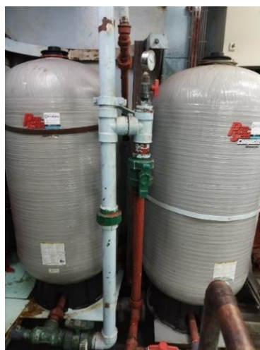
Figura 3. 1 Tanque Hidróforo Fuente: M/N Santa Cruz II – El Autor
