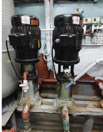
Figura 3. 3 Bombas Sistema Presión
