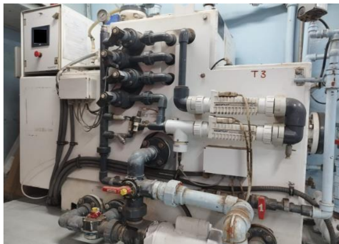
Figura 15 Planta de Tratamiento
