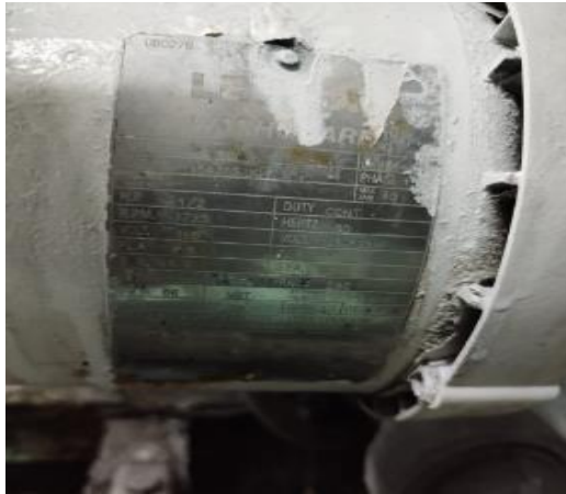
Figura 20 Bomba de Transferencia
