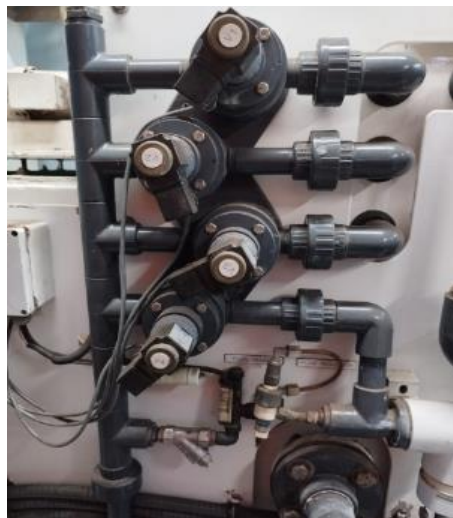
Figura 16 Válvulas de Ingreso de Agua de Mar
