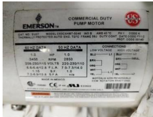
Figura 21 Bomba de descarga
