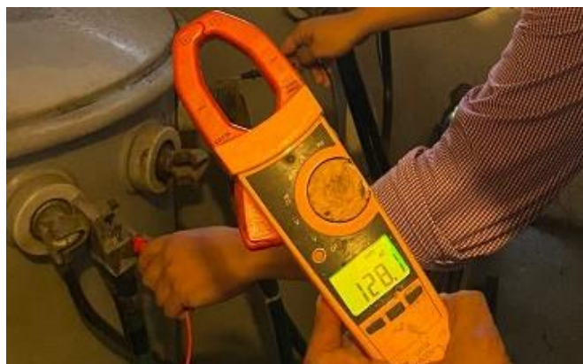
Figura 3.12: Voltaje trifásico del segundo transformador
