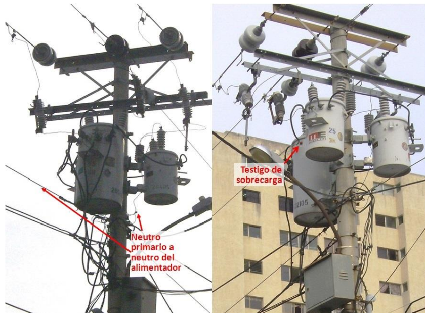
Figura 2.13: Banco de Transformadores
