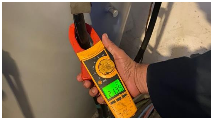
Figura 3.10: Medición de amperaje en la fase 3
