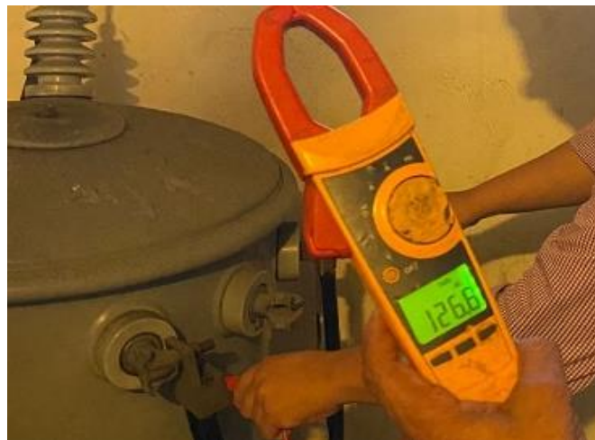
Figura 3.13: Voltaje trifásico del tercer transformador.
