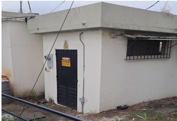
Figura 3.2: Cuarto eléctrico de la facultad técnica para el desarrollo
