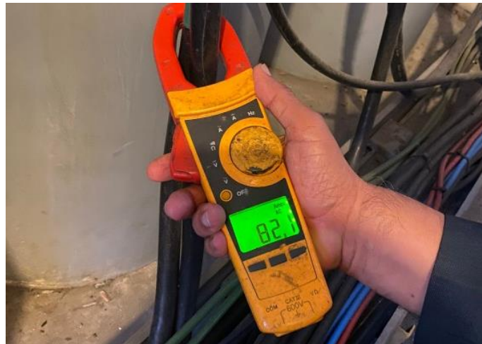
Figura 3.9: Medición de amperaje en la fase 2
