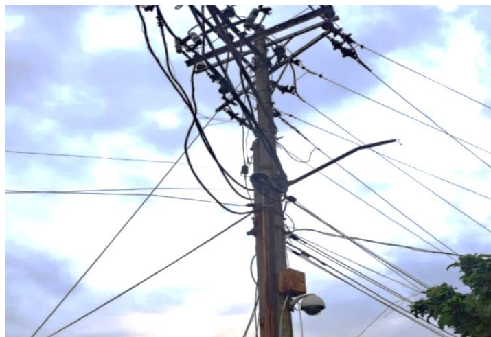
Figura 3.1: Poste de hormigón ubicado cerca del cuarto de transformación.
