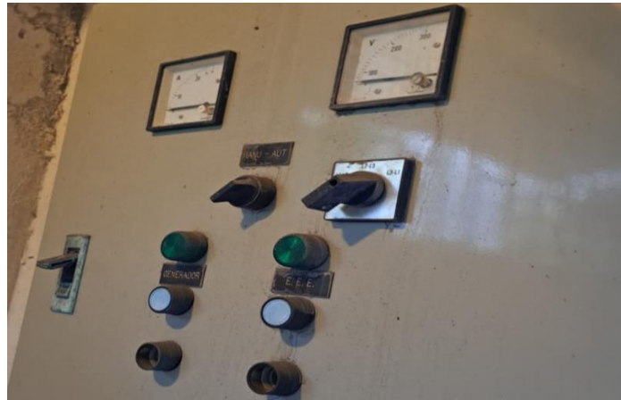
Figura 3.7: Tablero de Transferencia Manual (TTM) de la facultad técnica para el desarrollo
