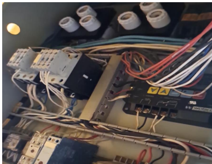
Figura 3.5: Conexión y distribución del tablero de automatización de la facultad técnica para el desarrollo
