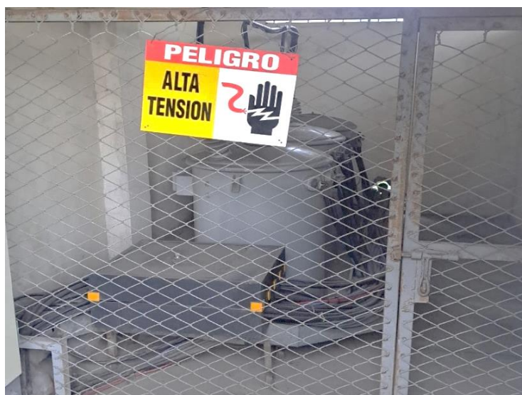
Figura 3.7: Cuarto de transformación con una potencia de 100 kva por transformador en conexión estrella trifásico.
