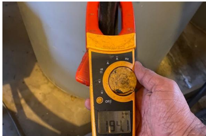
Figura 3.8: Medición de amperaje en fase 1
