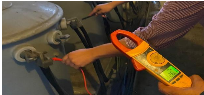
Figura 3.11: Voltaje trifásico del primer transformador
