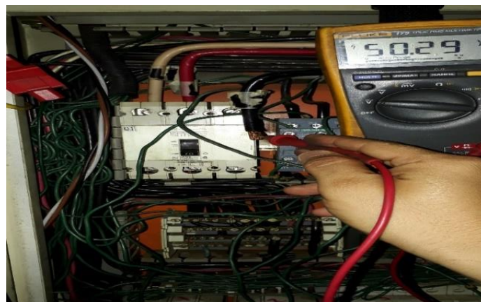
Figura 3. 2 Prueba de línea aterrizada en tablero eléctrico del ancla
