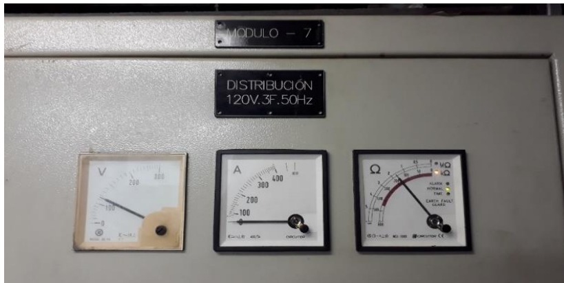
Figura 3. 1 Monitor de aislamiento operando normalmente
