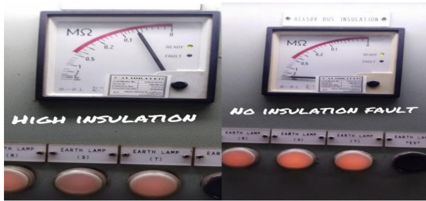
Figura 2. 16 Muestra Monitor de aislamiento y test de lámparas fugas a tierra
