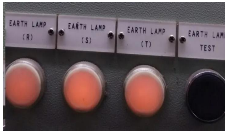
Figura 3. 12 Test de lámparas indicadoras fugas a tierra instalada en el tablero principal Fuente: Autor
