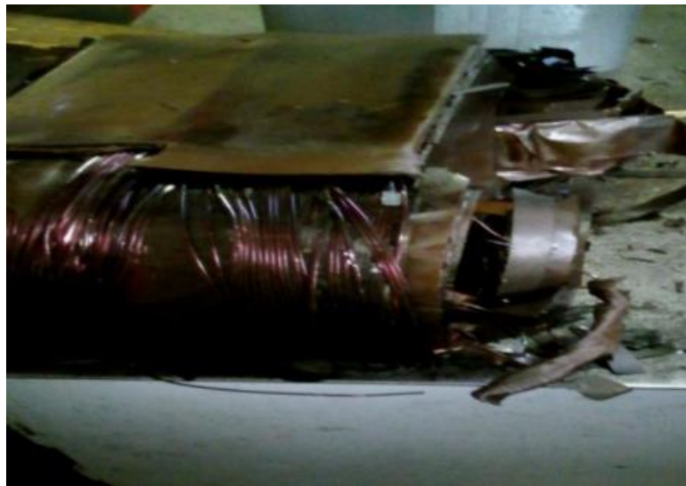
Figura 4. 4 Devanados dañados producto de un cortocircuito externo
