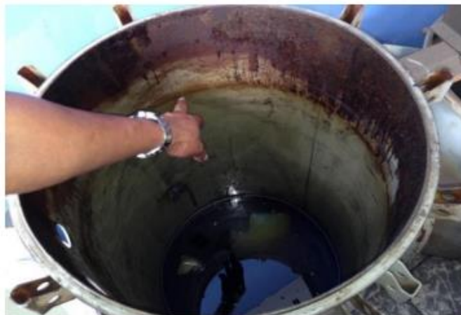
Figura 4. 2 Pintura interna del tanque de un transformador fallado por sobrecarga
