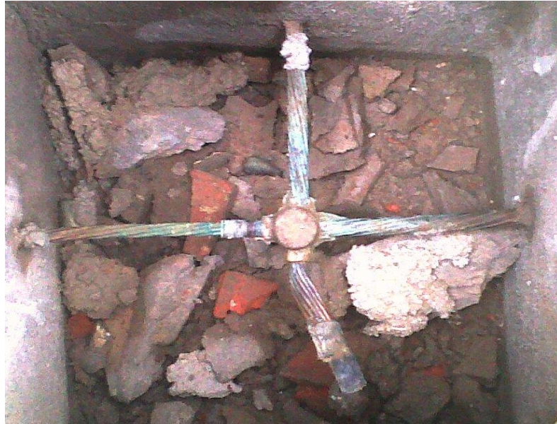
Figura 2.17. Corrosión del Sistema a tierra Fuente: Autor
