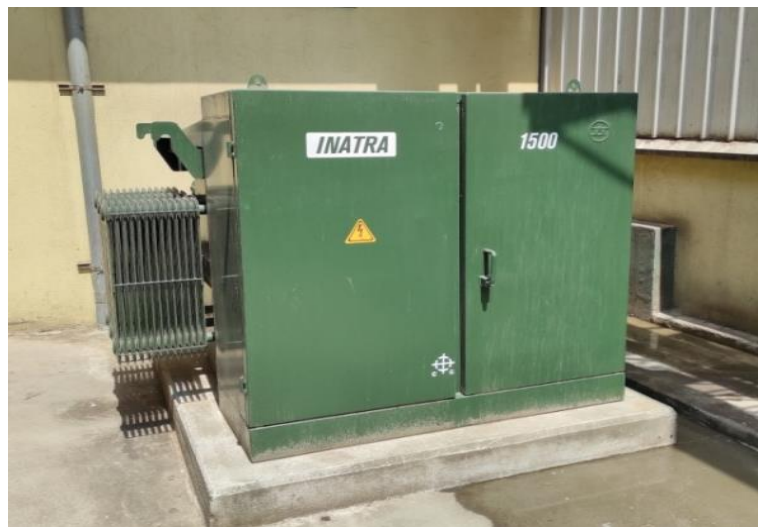
Figura 2.8. Transformador 1500Kva a 440Vac
