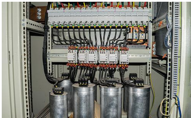
Figura 2.20. Interior de un banco de capacitores Fuente: Autor
