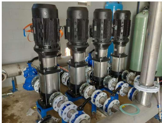
Figura 5: bombas centrífugas. Fuente: (Seguas, 2018)
