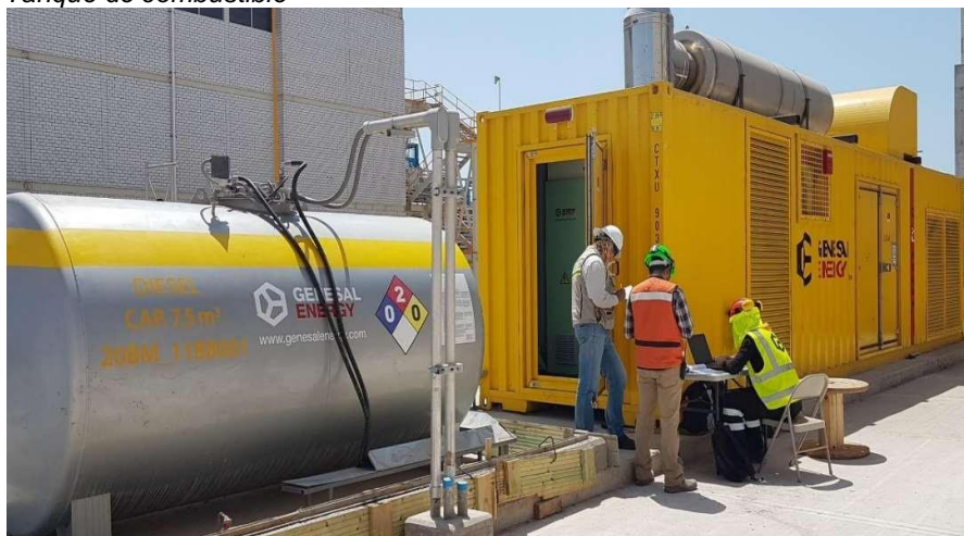
Figura 2.3 Tanque de combustible
