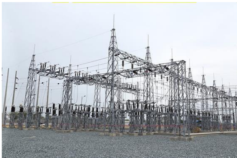
Subestación Durán de la CELEC
