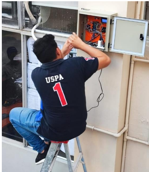
Figura 57: Colocación de la estación meteorológica en las instalaciones de la faculta de ingeniería
