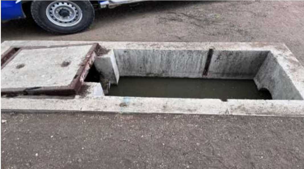
Ilustración 9 - Cámara de reparto
