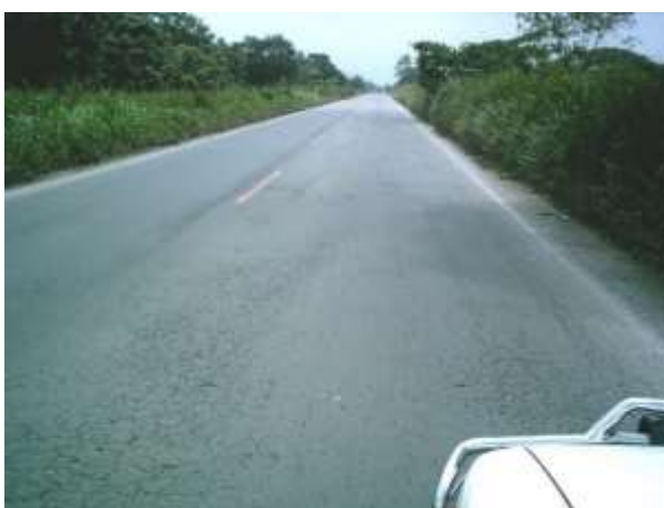
Figura 4.- Agrietamiento por fatiga tipo piel de cocodrilo - Tomado de: Clases de la asignatura de Pavimentos. UCSG. Ing. Rolando Vila, 2020.
