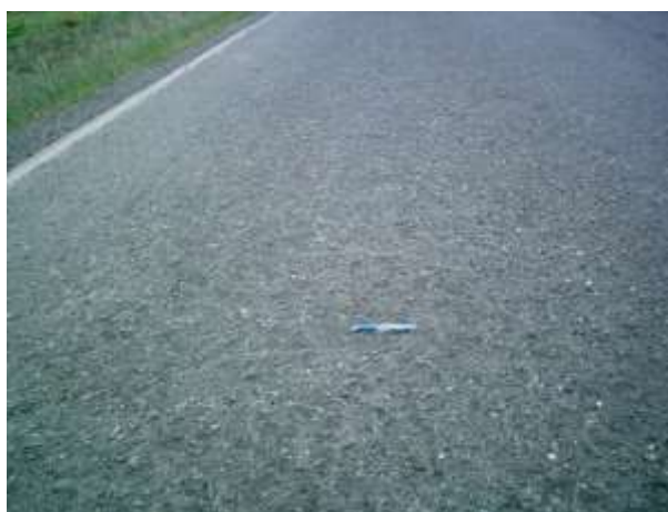
Figura 5.- Pavimento asfáltico con peladuras - Tomado de: Clases de la asignatura de Pavimentos. UCSG. Ing. Rolando Vila, 2020.
