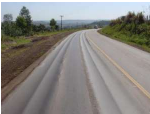
Figura 3.- Carril con ahuellamiento - Tomado de: Clases de la asignatura de Pavimentos. UCSG. Ing. Rolando Vila, 2020.
