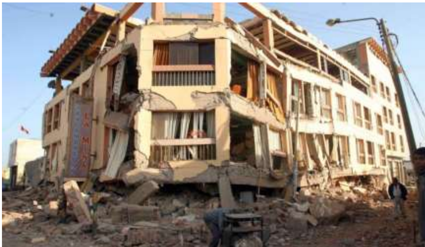
Figura 2. Hundimiento de piso en estructura tras terremoto en Pisco, Perú, 2007
