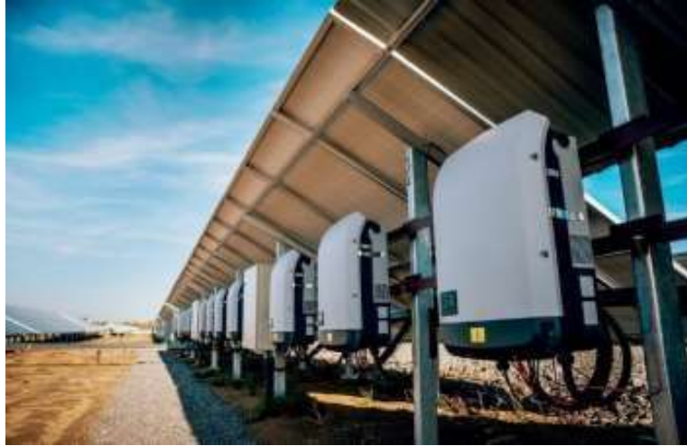
Figura 2.13. Inversor solar Fuente: Deltaglobal, 2009
