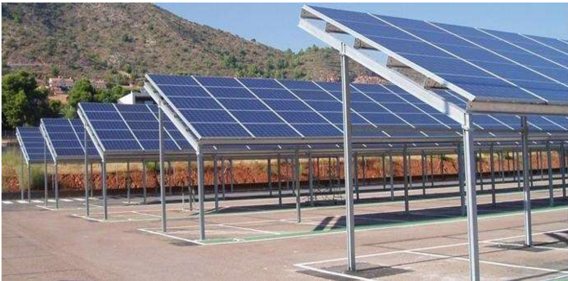
Figura 2.15. Soporte para inclinación de paneles solares Fuente: Deltaglobal, 2009
