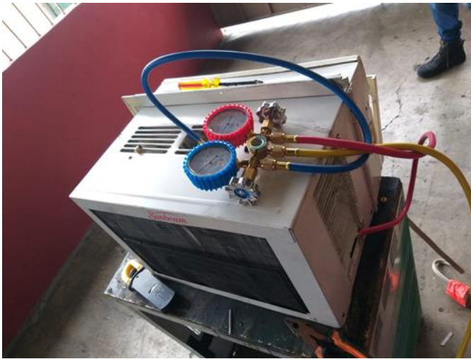
Figura 3.8: Equipo de Aire acondicionado y manómetros con manguera para medir la presión y controlar el paso de refrigerante durante la carga con R290.
