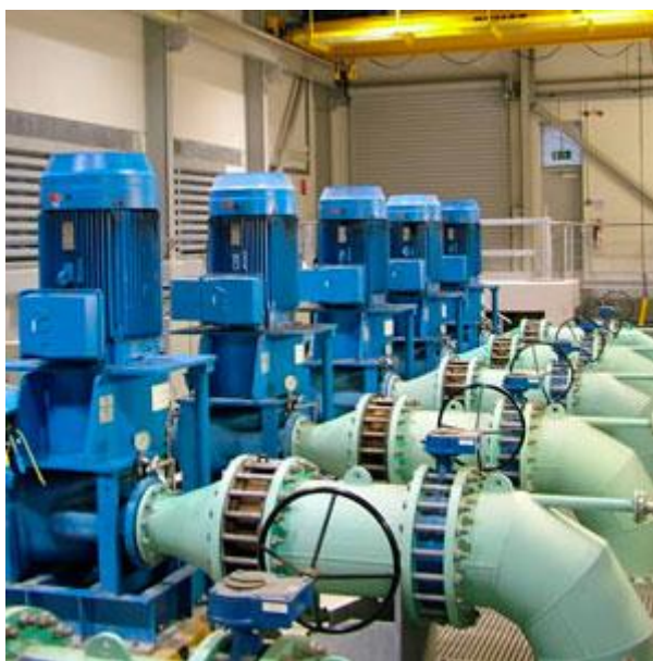
Figura 17. Equipos de bombeo para aguas residuales
