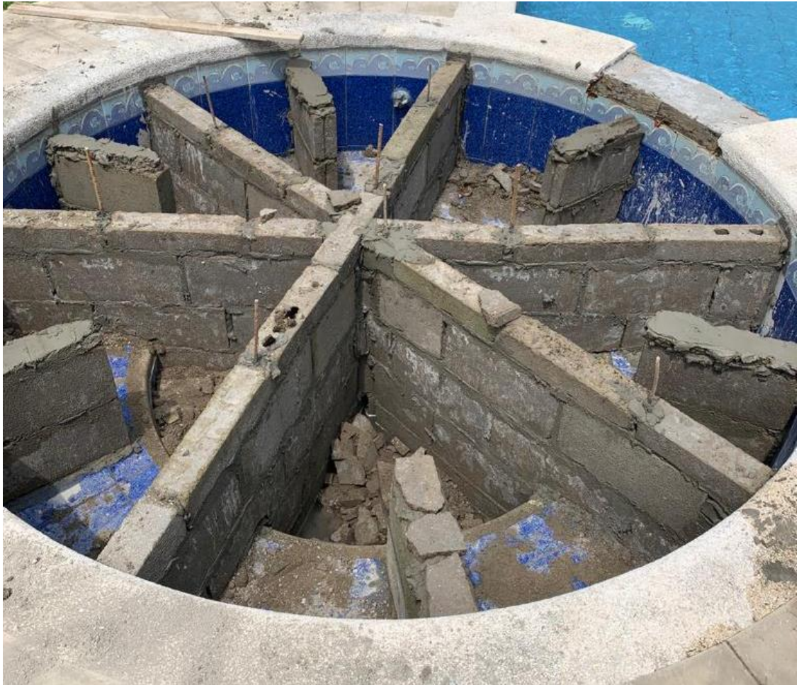
Ilustración 74. Colocación de refuerzos de bloques entre paredes para mejor soporte de la losa.
