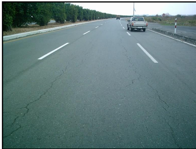
Figura 9. Agrietamiento descendente por fatiga.
