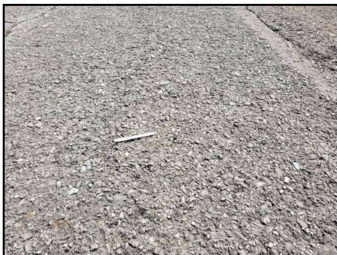
Figura 5. Pavimento asfáltico con peladuras.
