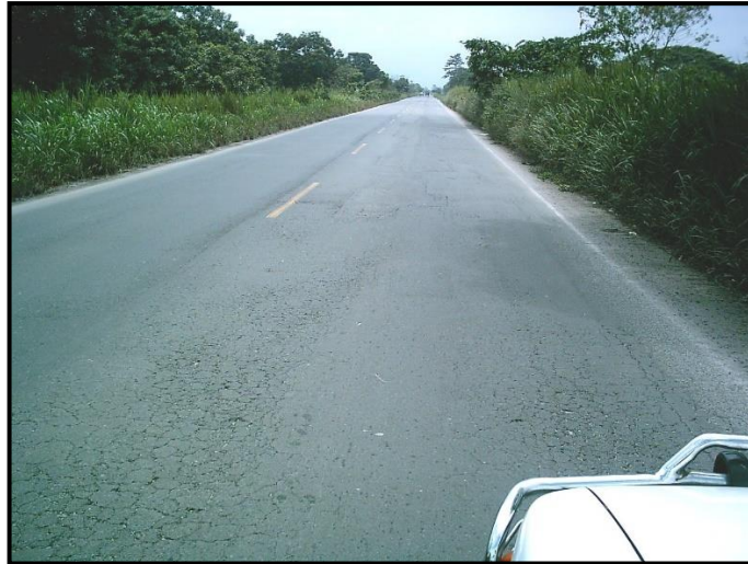
Figura 4. Agrietamiento por fatiga tipo piel de cocodrilo.
