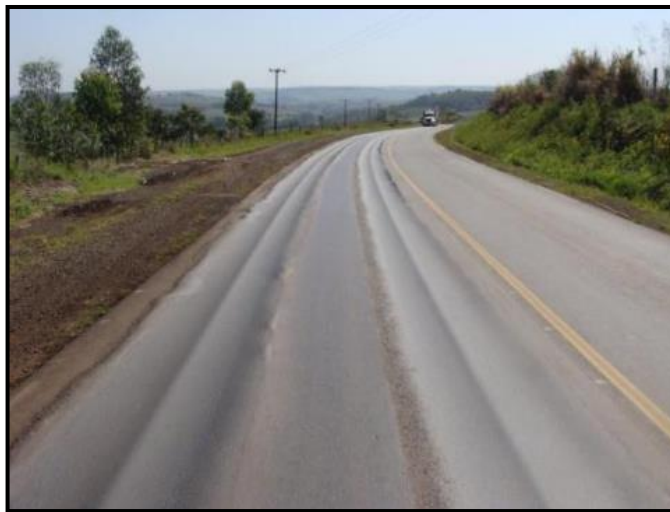
Figura 3. Carril con ahuellamiento.
