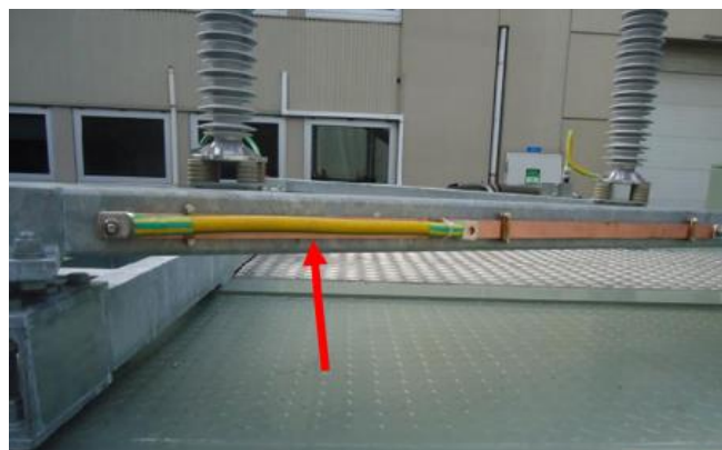
Figura 3. 28 Ubicación de los cables tierra de los pararrayos AT
