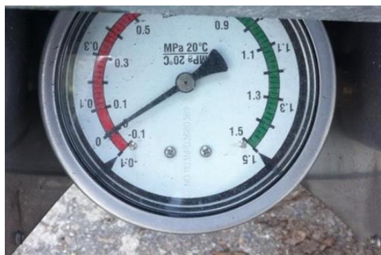
Figura 3. 14 Presión SF6 en nivel recomendado para transporte
