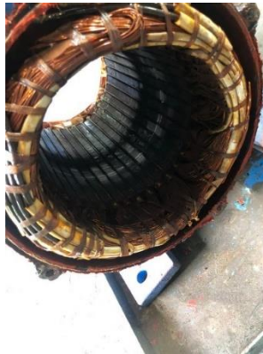
Figura 3. 6: Núcleo con falla a tierra.
