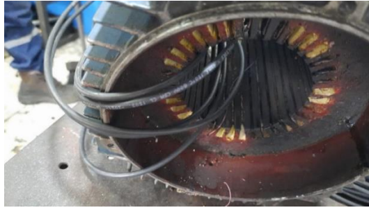
Figura 3. 5: Prueba de núcleo motor de 40HP con cable 8AGW
