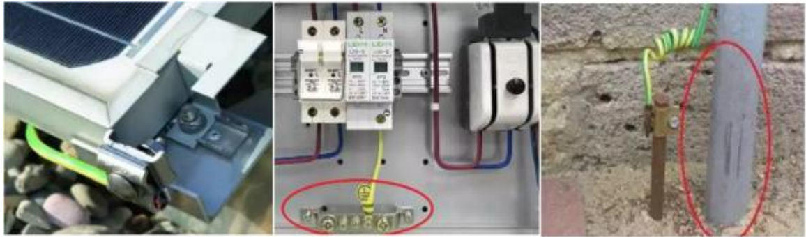
Figura 2. 24 Puesta a tierra en sistema fotovoltaico
